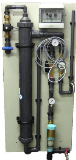
Abb. 9: Ultrafiltrationsanlage zur Sterilfiltration von Trinkwasser
