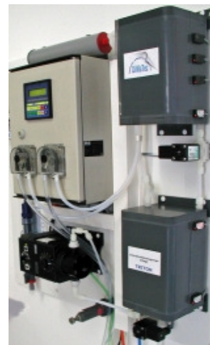
Abb. 10: Vollautomatische Chlordioxidierungs- und Dosieranlage mit höchstem Sicherheitsstandard.
